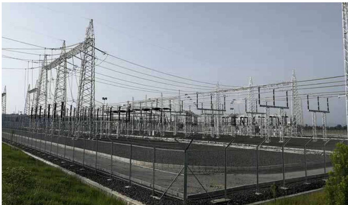
埃塞俄比亚伊加莱姆 II 和哈瓦萨 II 变电站项目 Yirgalem(Phase II) and Hawassa(Phase II) Substations Project in Ethiopia
