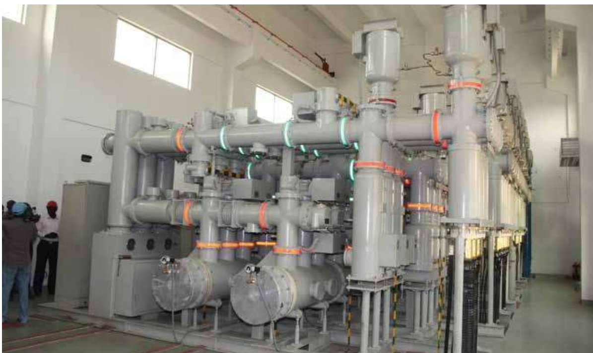
塞内加尔达喀尔 90kV 环城输变电项目 Boucle 90kV de Dakar Project in Senegal
