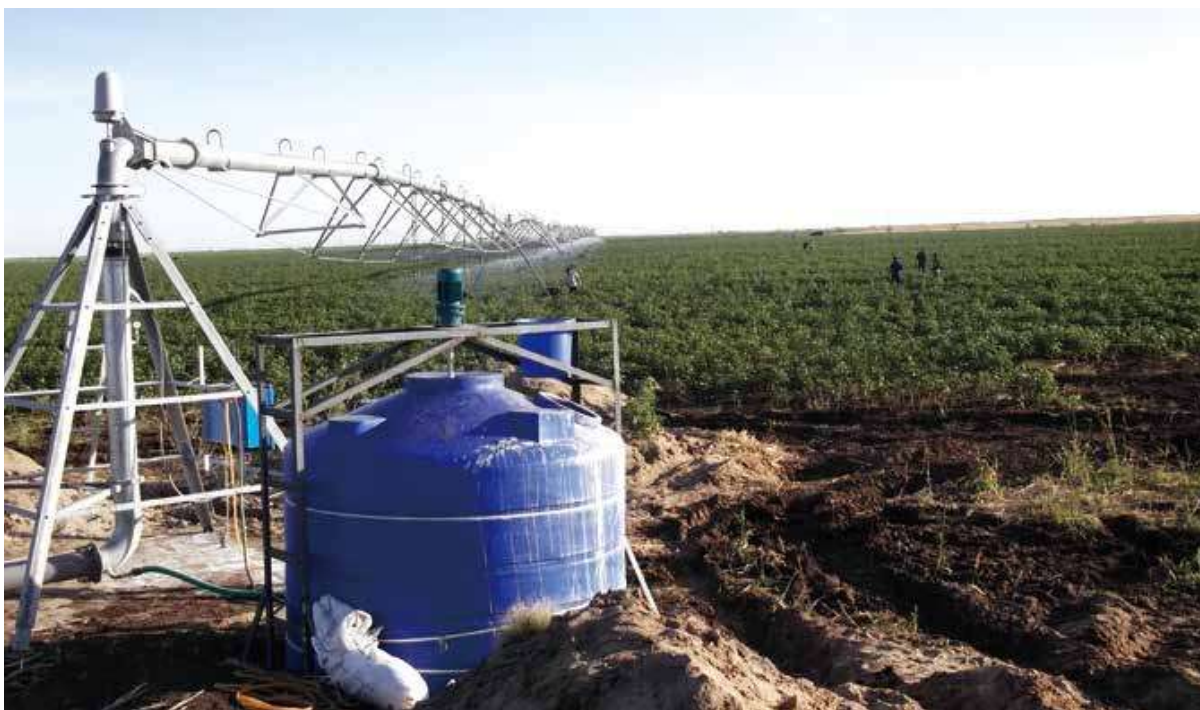
苏丹青尼罗河灌区修复项目 Blue Nile Scheme Rehabilitation Project in Sudan
