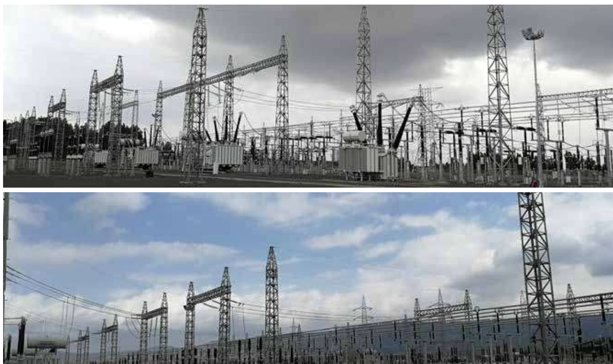
埃塞巴赫达尔 - 德卜勒马科斯 - 亚的斯亚贝巴 400kV 输电变电站设备和土建项目 Bahir Dar - Debre Markos - Addis Ababa Power Transmission Project in Ethiopia
